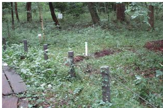
井戸掘削工事終了後です。地上に0.5mの白い管が見えます。
